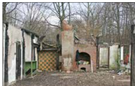
Ansicht der Herdwand nach dem Brand
